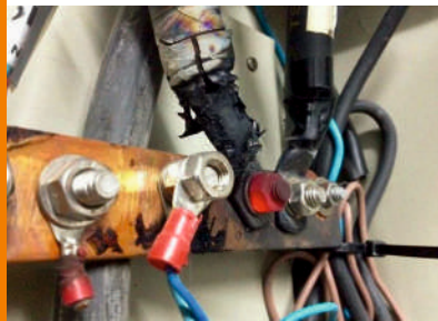
Нарушение правил эксплуатации
